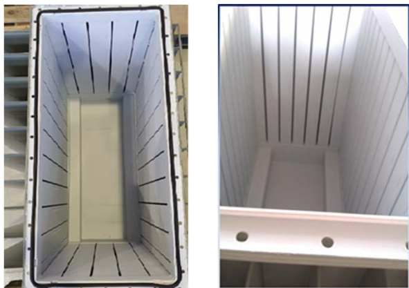
Slika 1 - Unutrašnjost kotlova distributivnih transformatora
